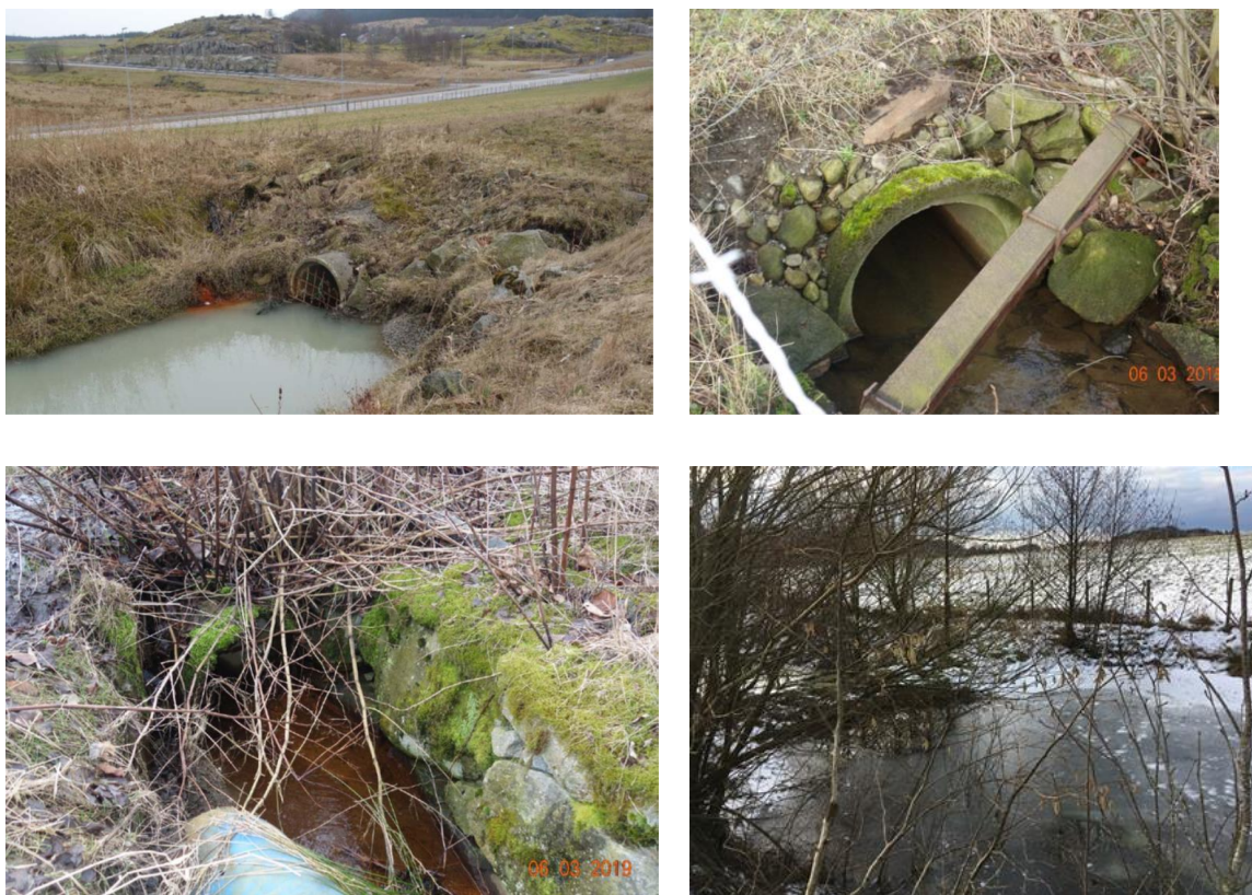
Figur 12.9. Eksempel på rusk og rask som reduserer kulvertens kapasitet. I kulverten øverst til venstre bør gitter foran kulverten fjernes for å unngå tilstopning. Bildet nede til høyre viser rensedam i Hanabekken som bør tømmes.
